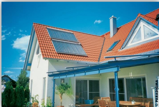
napkollektor elhelyezése belső (udvarra néző) tetőfelületen
